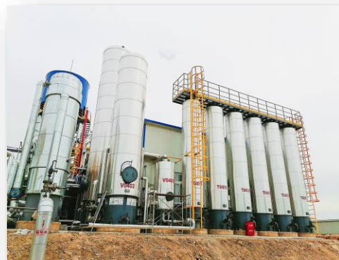
辽宁葫芦岛天然气制氢项目
