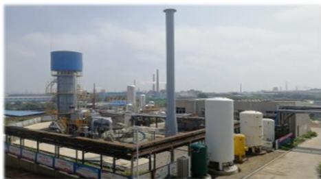
辽宁天然气制氢项目
