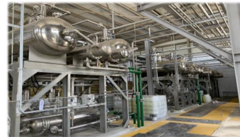
北京冬奥会氢能产业化应用示范园
